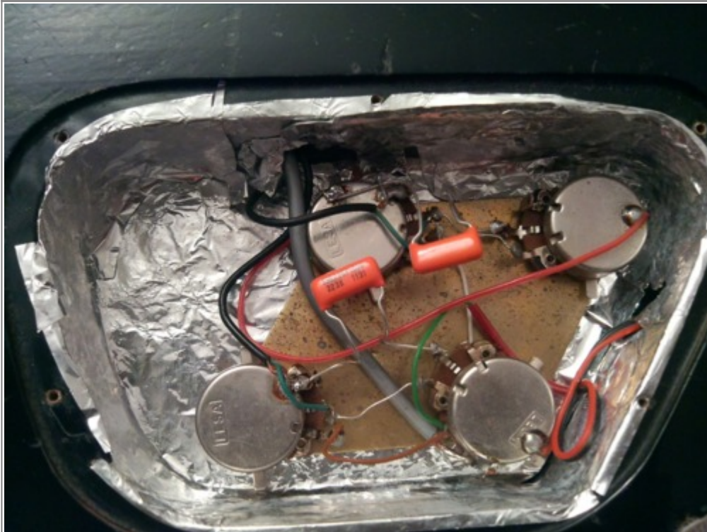
Les nouveaux condensateurs installés.
