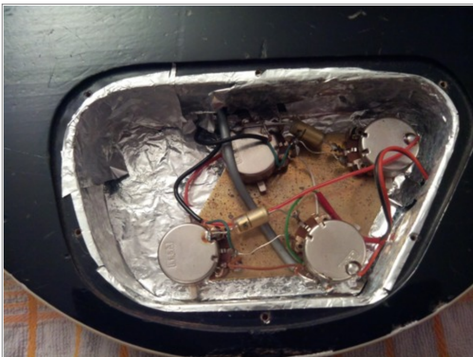
Les condensateurs originaux encore en place.
